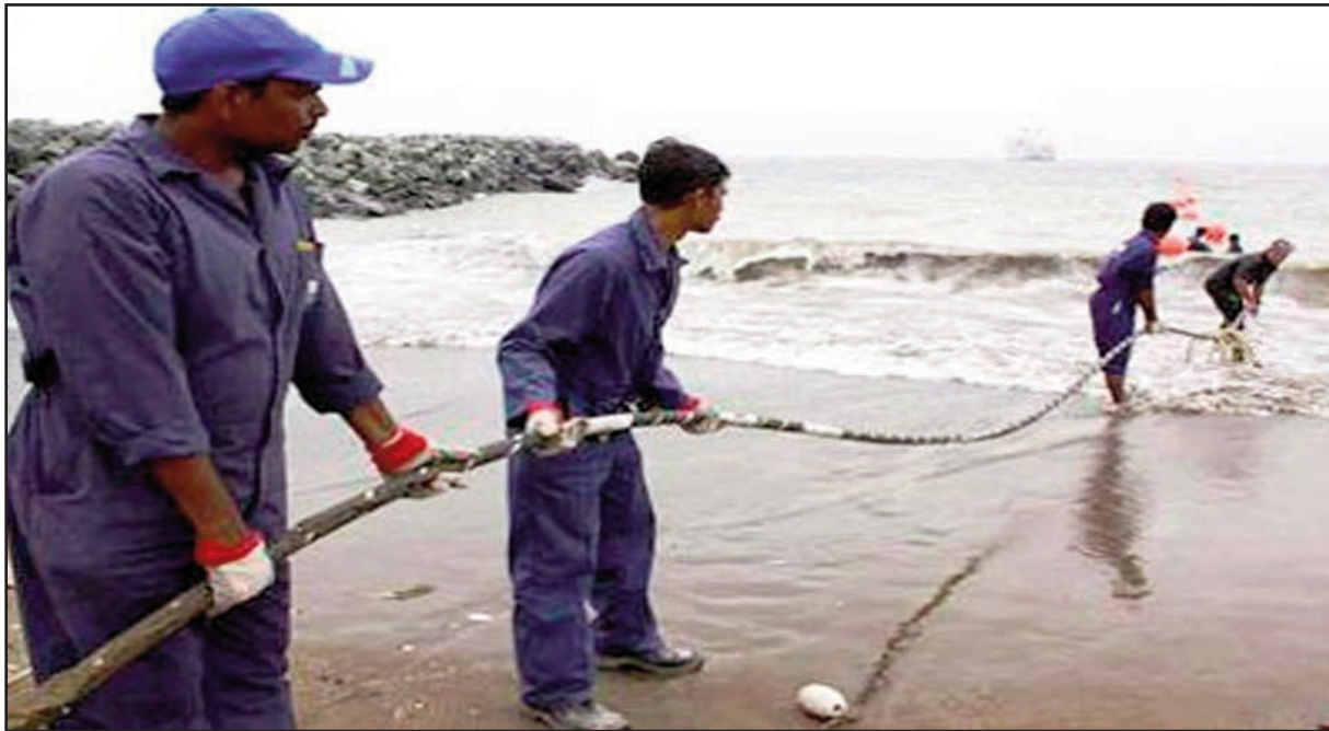
Le câble sous-marin SAT3
